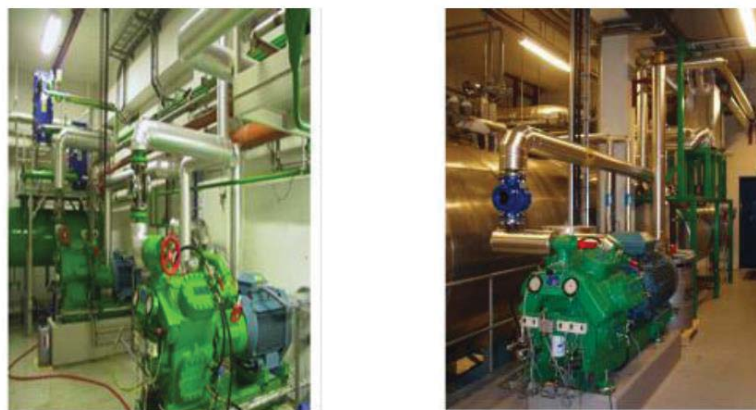
図 3-11: 二つのハイブリッドヒートポンプ“Hybrid Energy AS” 加熱能力 左: 300 kW, 右: 650 kW [Nordtvedt, 2009]
